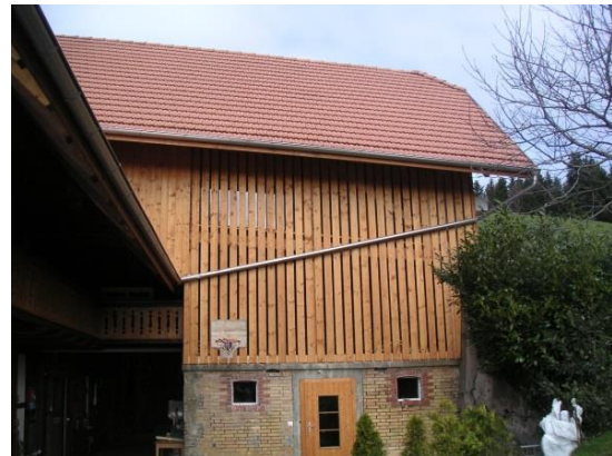
Verbretterung Wand bei Hocheinfahrt
